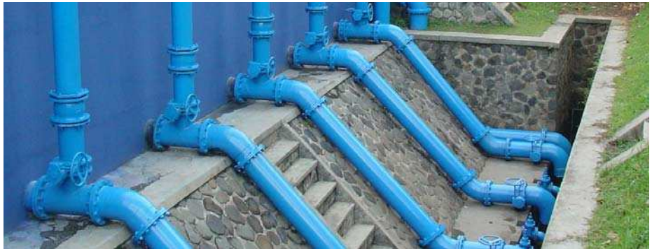
Sistem perpipaan pada sebuah unit instalasi pengolahan air minum. Foto: Istimewa
