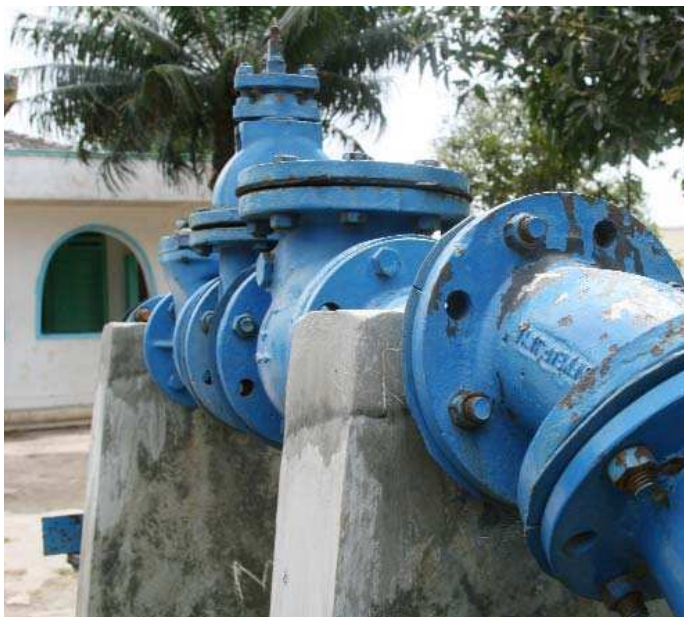
Sarana instalasi air bersih untuk mengalirkan di dua kelurahan. Foto: Bowo Leksono
