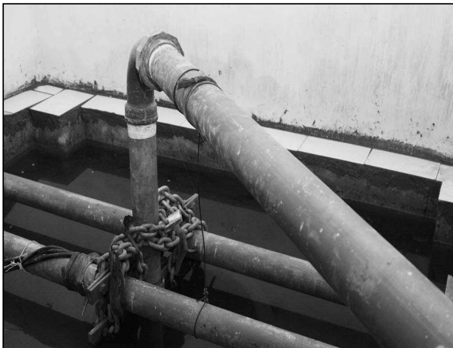
Sistem perpipaan untuk mengambil air baku dari sumber air untuk dialirkan ke bak penampungan. Foto: Bowo Leksono.
