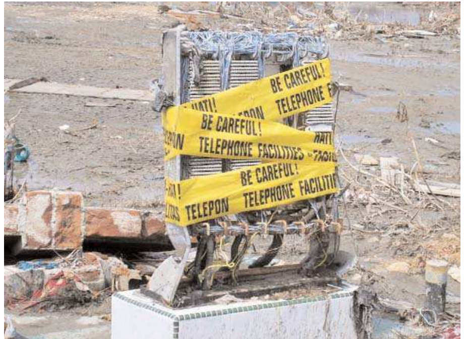
■ Infrastruktur rusak: Sarana telekomunikasi ikut hancur diterjang gelombang tsunami. ■
