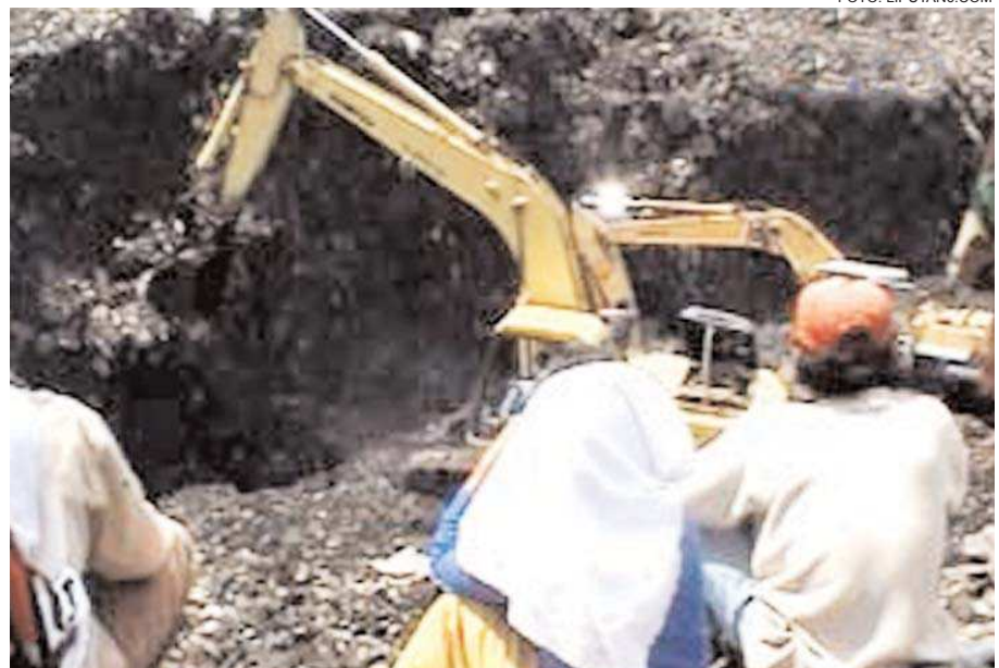
■ Cari jenazah: Escavator ikut menggali timbunan sampah yang mengubur warga. ■
