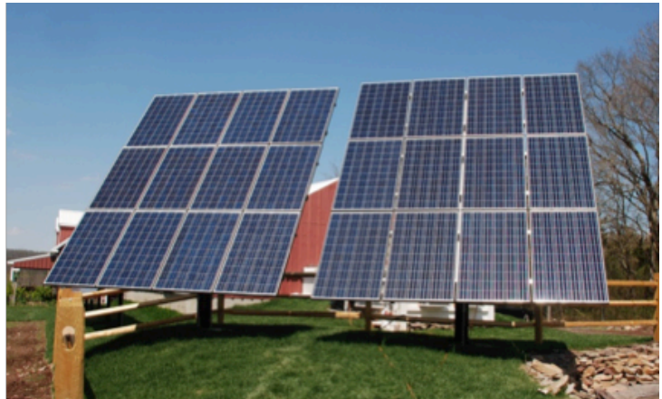
Proyek Tenaga Surya Fotovoltaik di Utara Amerika – sudut kemiringan rendah. Sumber Foto: Dan Jordan
