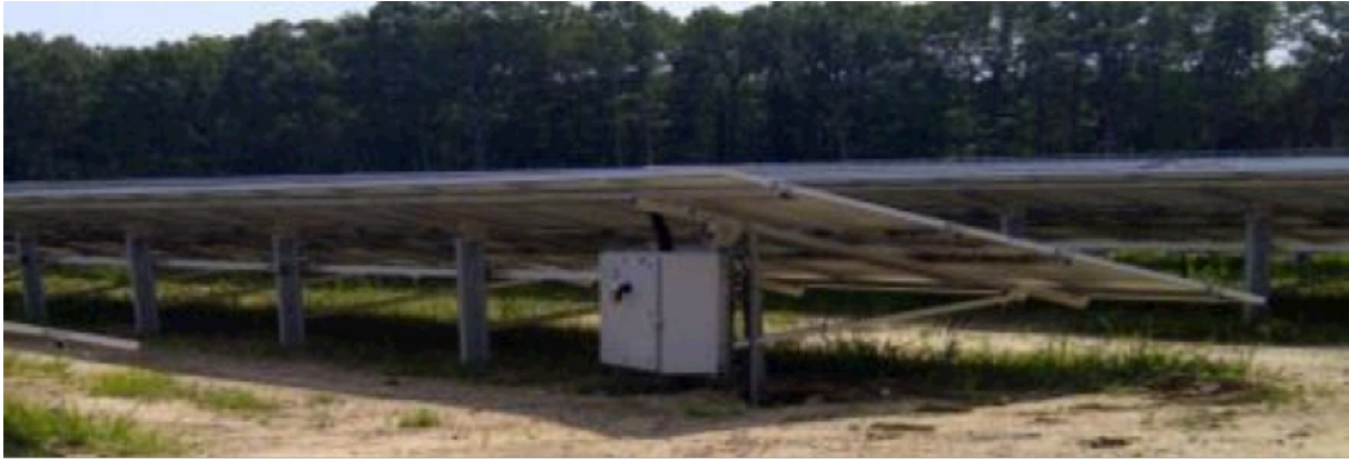
Panel, Kotak Combiner, Struktur Rangka, Kabel. Sumber: Triad Engineering. Foto: Dan Jordan
