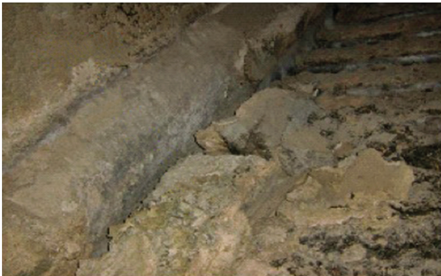
————— GAMBAR 55 ————— KLINKER YANG TERBENTUK DI PANGGANGAN BOILER
