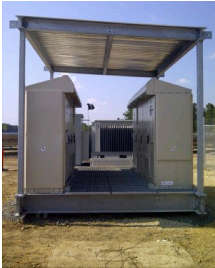
500kW Inverter ganda dengan sebuah tranformator 34.5kV yang dirangkai sebelumnya pada suatu struktur. Sumber: Triad Engineering. Foto: Dan Jordan
